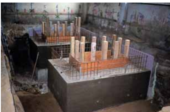
Zwei der schwingungsentkoppelten Fundamente für Rastersondenmessapparaturen.
